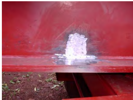
Foto 3, rotura por fatiga. Fatigue failure
