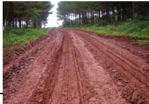
Imagen n° 9: Consolidado con tosca deteriorado por falta de despeje Picture n° 9: Road impaired by lack of clearing
